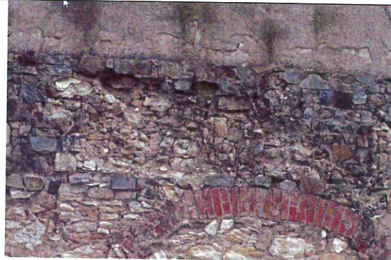
Fot. 25/E. Widok uszkodzonych zabezpieczeń kwarcytowych od strony dziedzińca
