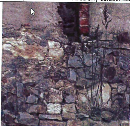
Fot. 26/E. Uszkodzenia nadmurowania z kwarcytu Rozluźnione połączenia między kamieniami, rozwój roślinności.
