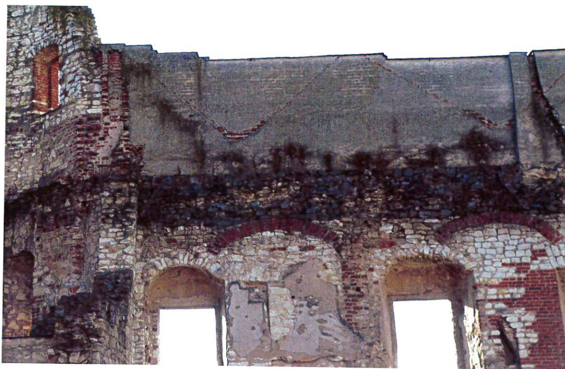
Fot. Sekcja E Widoczne ciemne, zawilgocone partie muru związane z korozją biologiczną i chemiczną.
