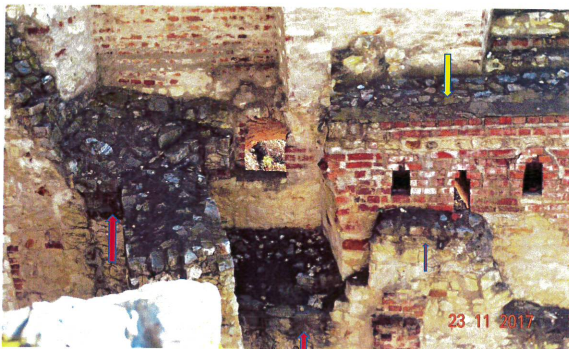
Fot. 39 Sekcja B korony strzepów murów z widocznymi licznymi zniszczeniami w obrębie przemurowań (żółta strzałka) i poniżej w wątku kamiennym (czerwona strzałka).
