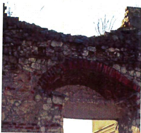
Fot. 33/F. Uszkodzenia muru nad nadprożem ceramicznym
